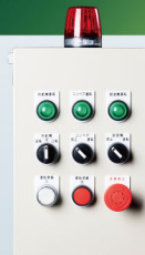
制御盤 操作スイッチ
